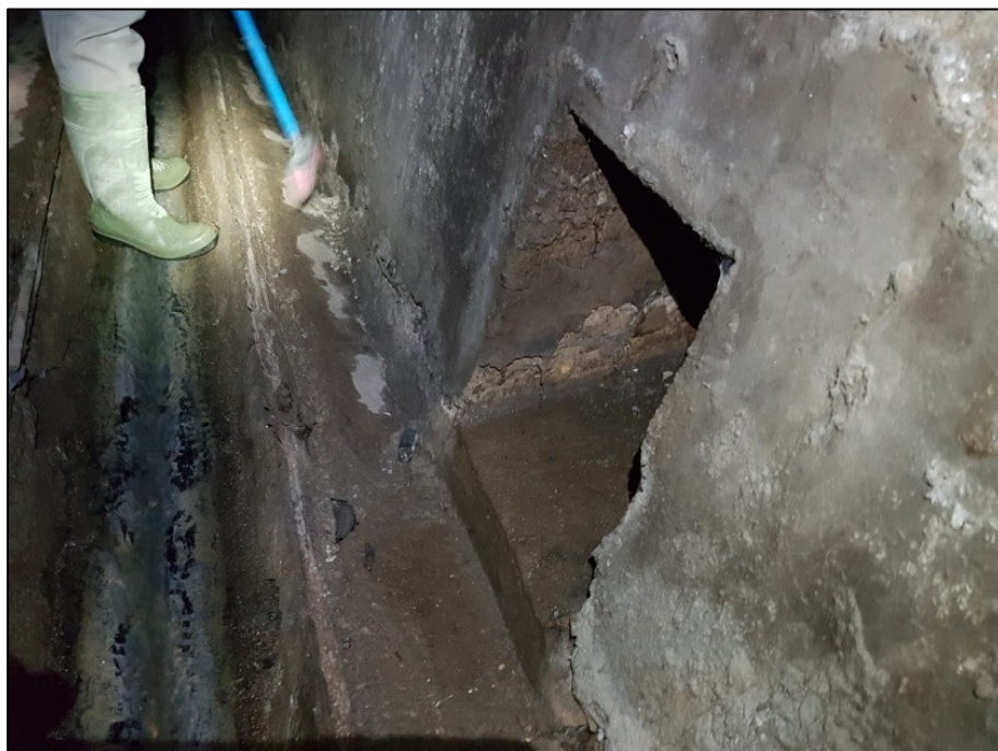
Fig. 37. Evidència d'obertura al col·lector a set metres al sud de l'accés al refugi ( Font: Crobiser).
