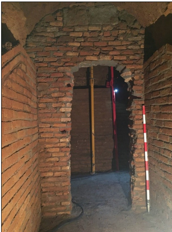
Fig. 27. Vista de l'obertura en el tapiat (UE 12), des de la part interior.
