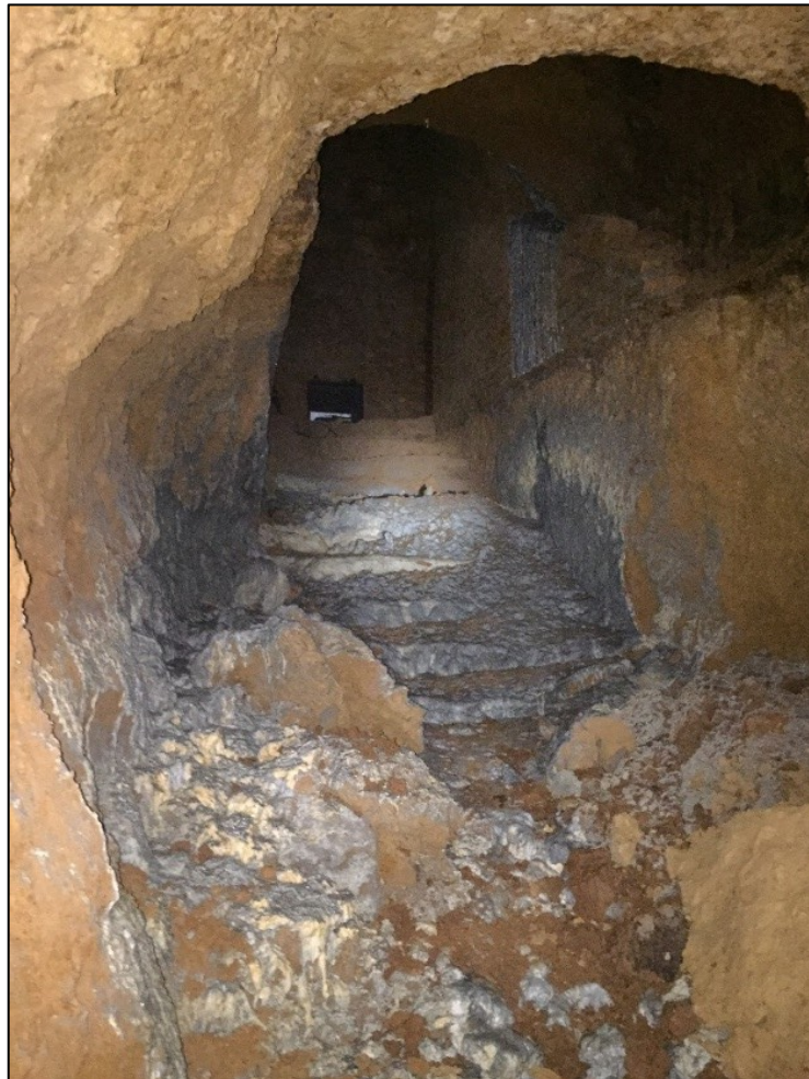
Fig. 36. Part de la zona d'afectació del ciment líquid injectat en la construcció del garatge.
