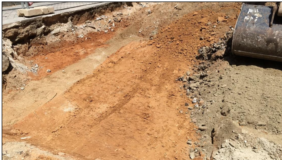
Detall dels nivells un cop rebaixat el carrer i des de la vorera del carrer Radas.
