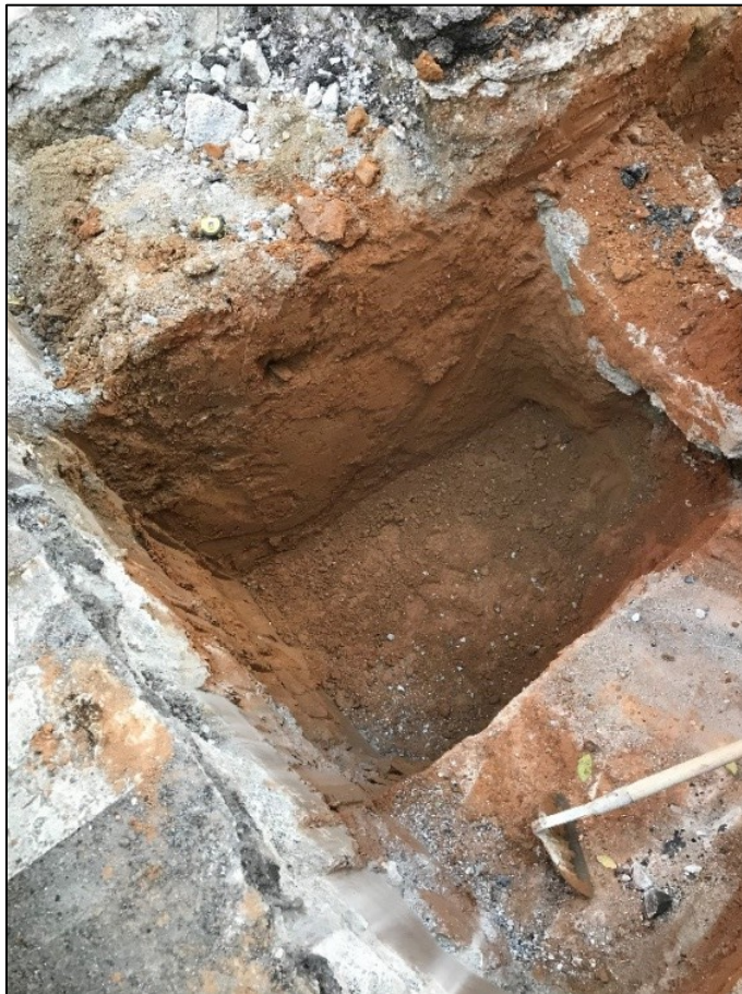
Fig. 13. Caixa de connexió dels col·lectors a la zona del carrer Anníbal.
