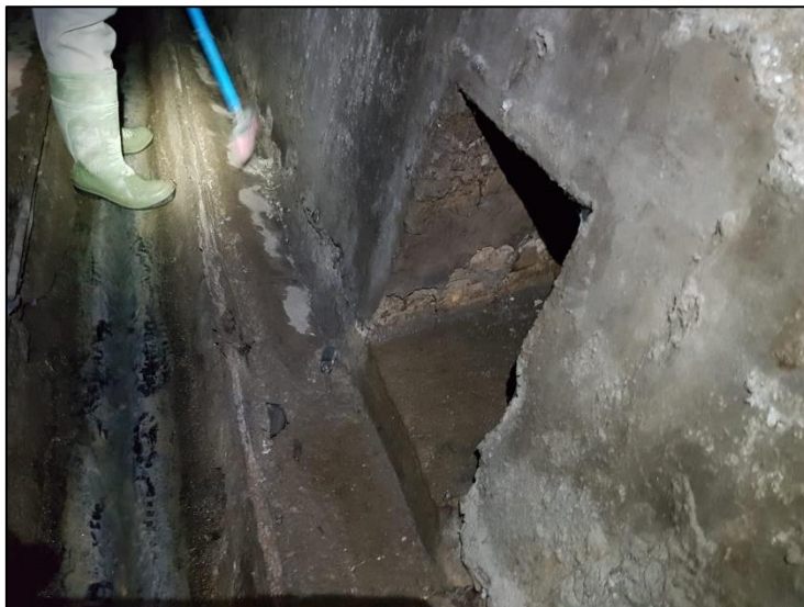
Evidència d'obertura al col·lector a set metres al sud de l'accés al refugi (Font: Crobiser).
